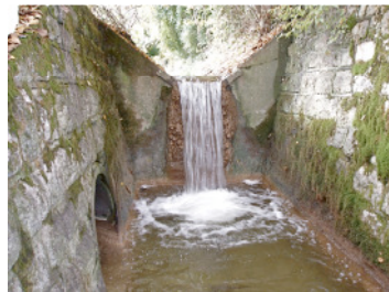
Uferverbau mit hohem Absturz
